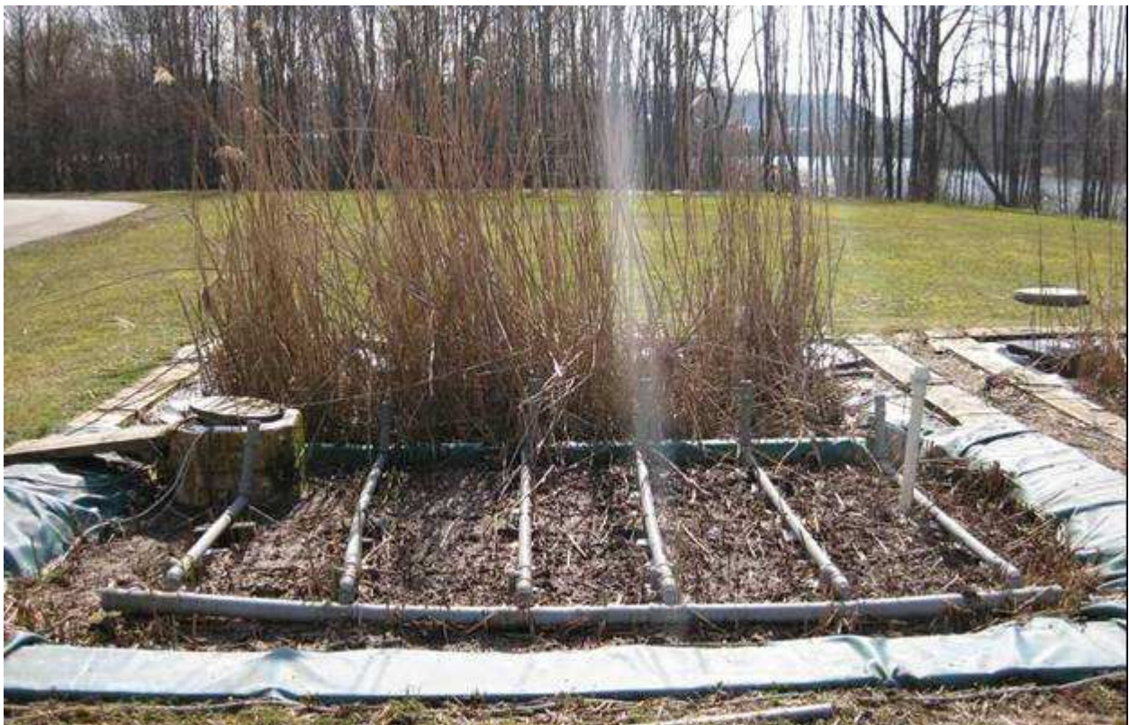
Abbildung 86: Bodenfilter BF3 am 25. März 2009, vor der Reinigung der Oberfläche von BF3.1
