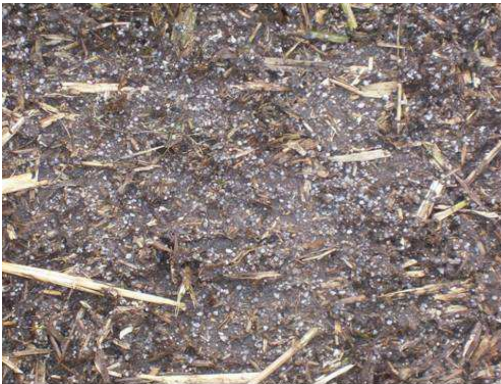
Abbildung 56: Filterschicht in BF3.1. Bereich wo Abwasser schlecht infiltrierte. Filtermaterial stark vererdet/verschlammt.
