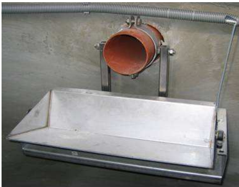
Abbildung 8: Ablaufwippe im Abwasserpumpschacht
