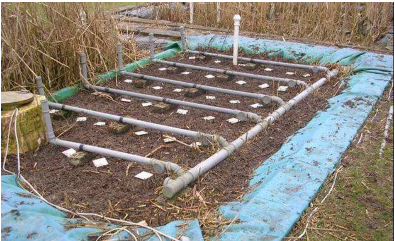
Abbildung 88: Bodenfilter BF3 am 25. März 2009, nach der Reinigung der Oberfläche von BF3.1
