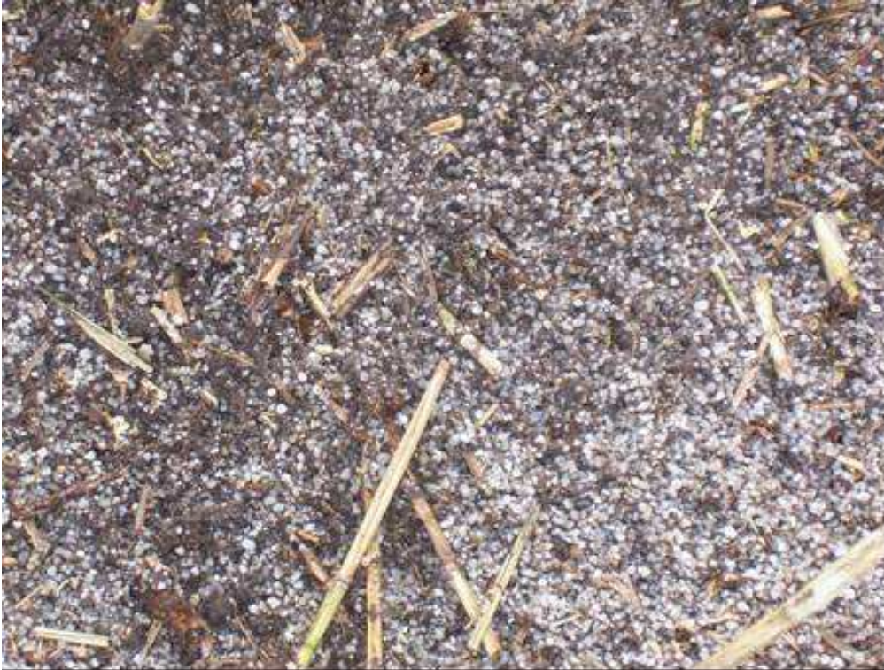
Abbildung 57: Filterschicht in BF3.1, Bereich nahe dem Pumpschacht. Filtermaterial ebenfalls vererdet/verschlammt, jedoch weniger stark.
