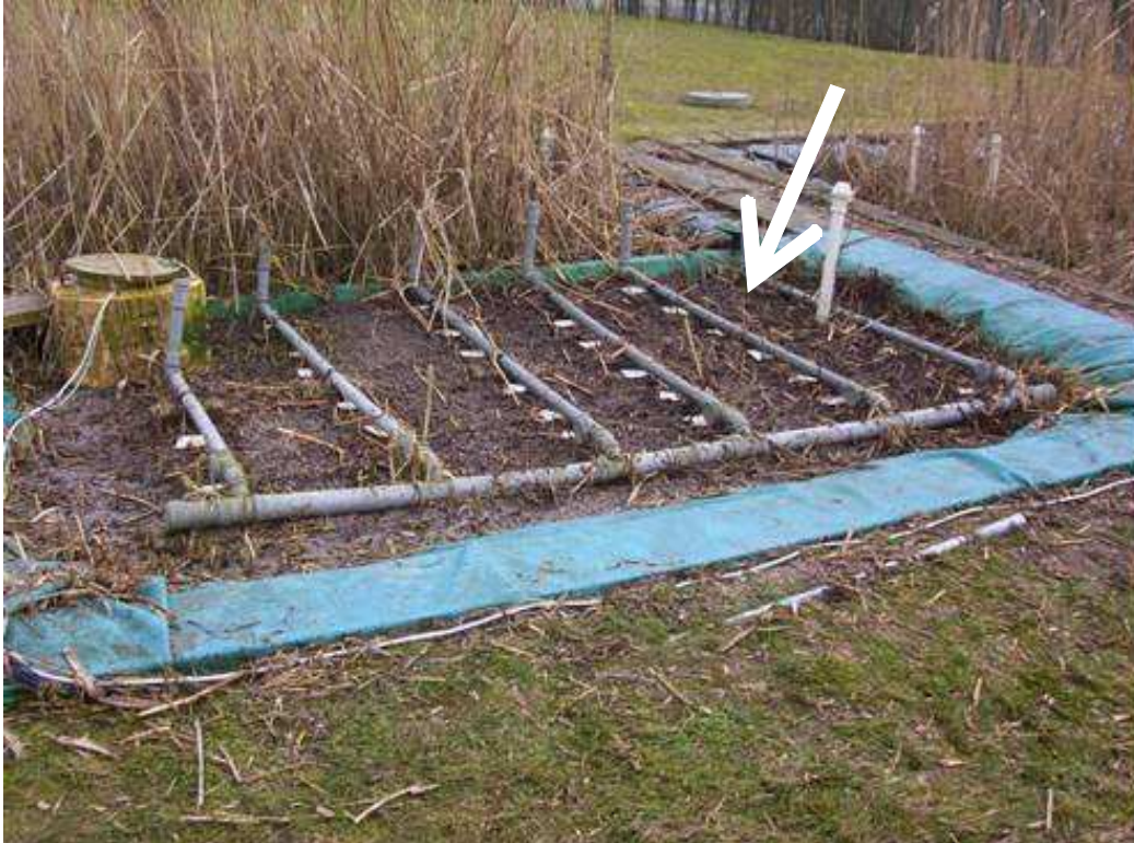
Abbildung 55: BF3.1 nach Entfernen des Schilfs: Am rechten Rand des Fotos ist der Bereich, wo das Abwasser nur verzögert infiltrierte, durch einen Pfeil gekennzeichnet.
