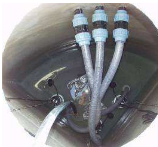
Abbildung 6: Dritte Kammer der 3-Kammer-Absetzanlage mit den 3 Beschickungspumpen
